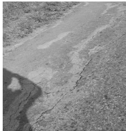
(F-6) Falla por desplazamiento y asentamiento
