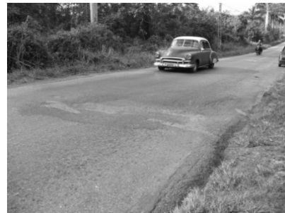
(F-4) Deterioro en calzada
