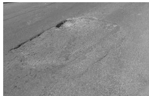
(F-18) Afectación en pavimento
