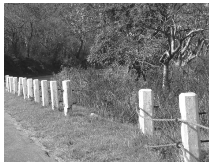
(F-12) Defensas en mal estado
