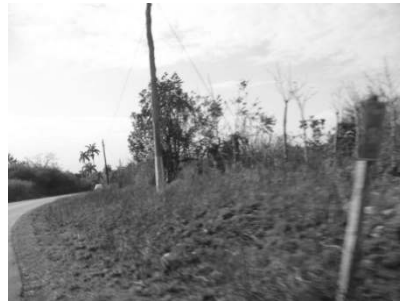
(F-16) Ausencia de cunetas y estado de las señales
